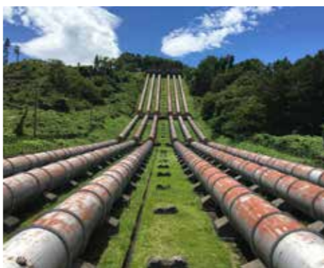
猪苗代第一発電所
